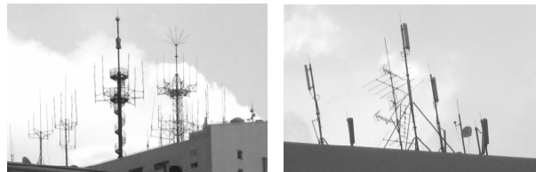
图2 成都市某办公楼、居民楼顶的基站天线林立情形
