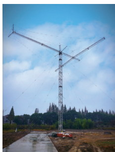
图8 天线场实际架设天线照片
